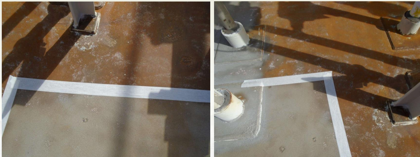
Fig. 25 - Teste campo de trecho de piso hidrojetado com e sem inibidor após 16 h.
