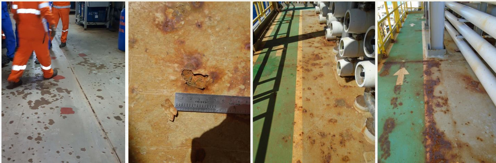
Fig. 13 - Baixa integridade anticorrosiva em pisos em unidades offshore
