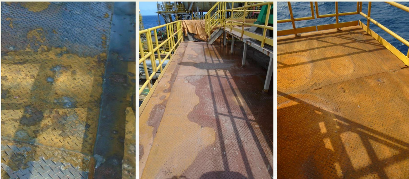
Fig. 4 - Ocorrência de flash rust em pisos
